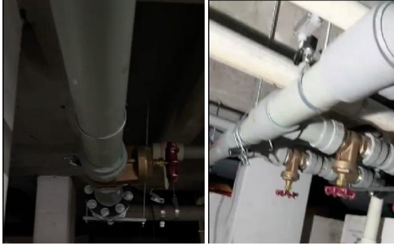
Imagen 7,8. Avance Instalación equipo de bombeo para conexión de bombas y salida de descarga general.
