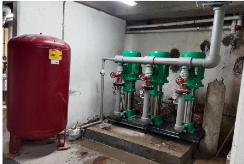
Imagen 32. Montaje general de equipo de Bombeo línea de alta Presión.
