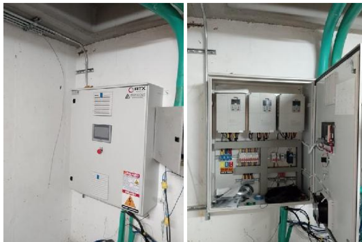
Imagen 9,10. Posicionamiento y conexonado de tablero de control.
