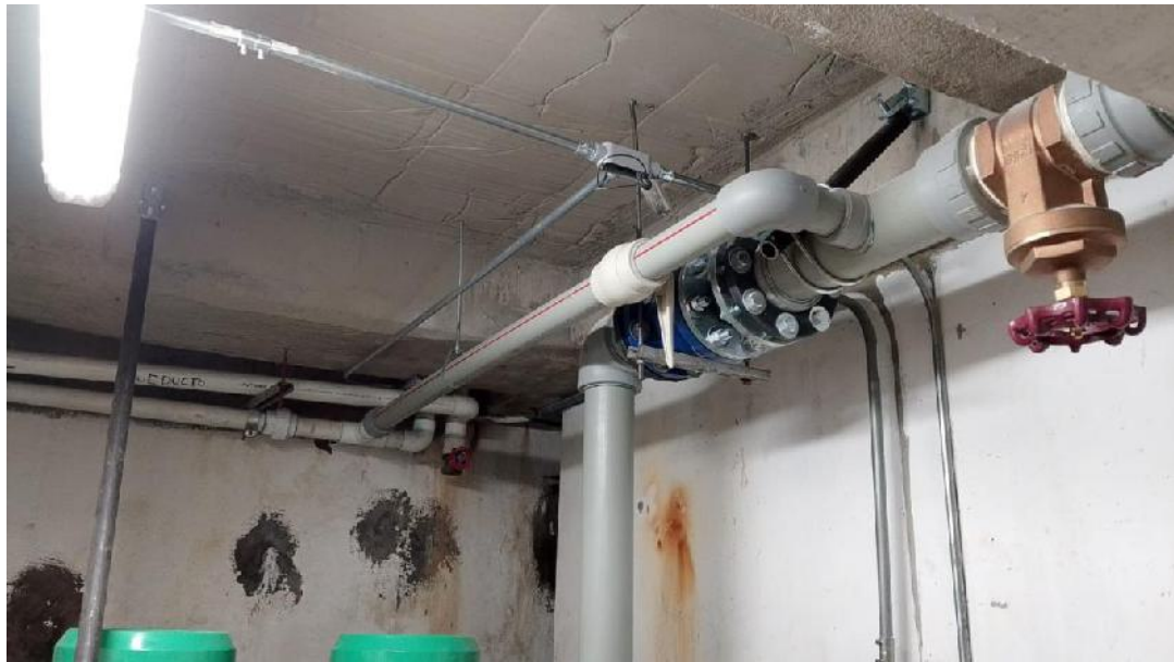
Imagen 33. Conexión a descargas generales y by pass.
