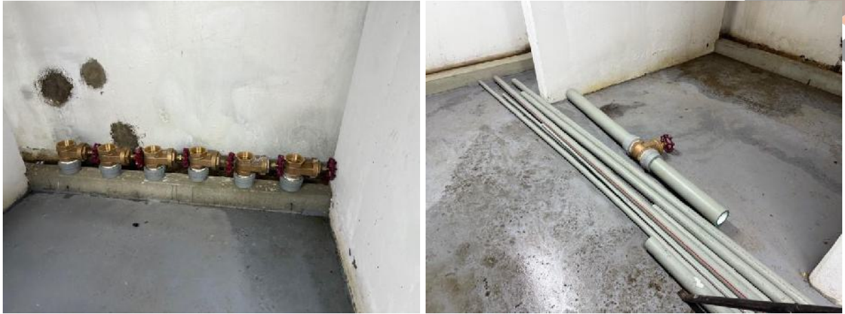
Imagen 23,24. Preensamble general de cuartos de bombas Alta y baja presión
