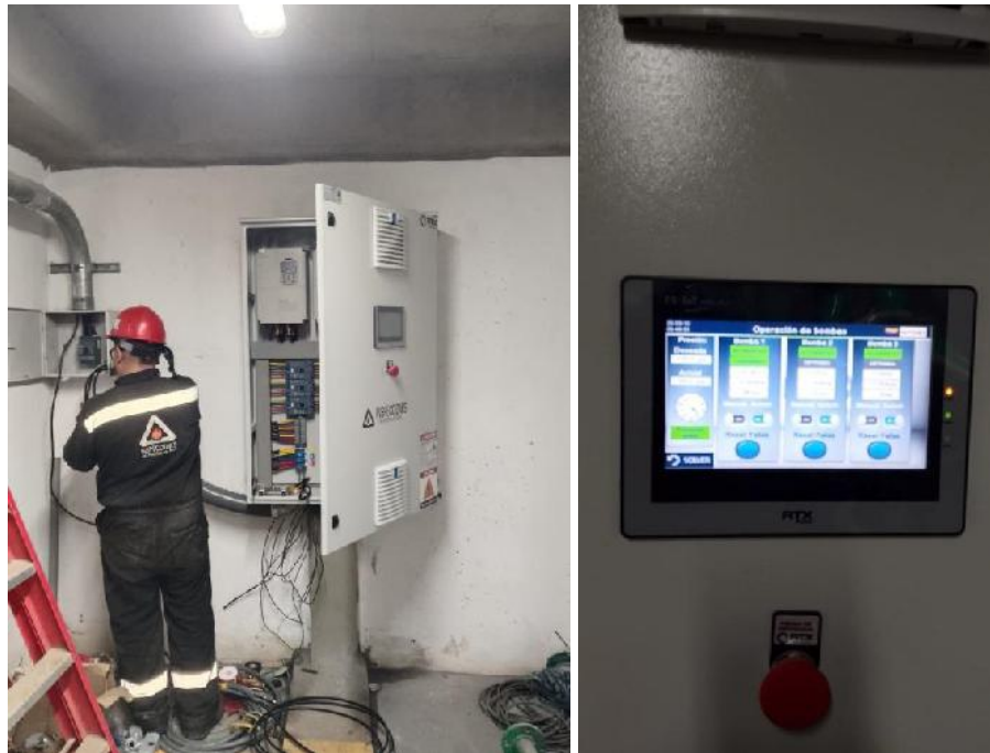
Imagen 34, 35. Proceso de Conexión de Tablero Eléctrico y pantalla operativa del sistema de bombeo línea de alta presión
