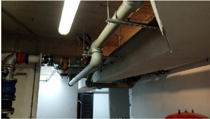
Imagen 25. Instalación de descargas generales hasta transición de PPR a Pvc-P, incluyendo válvulas y cheques de descarga general y by pass entre equipos.
