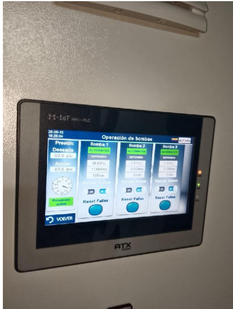
Imagen 19. Tablero de control con presión actual del sistema de baja presión.
