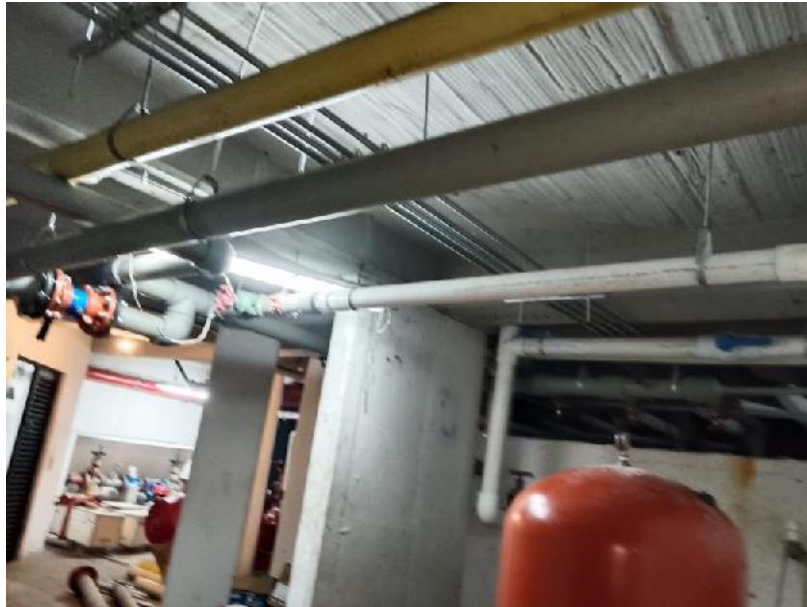
Imagen 17. Instalación general equipo de baja presión finalizado y operativo
