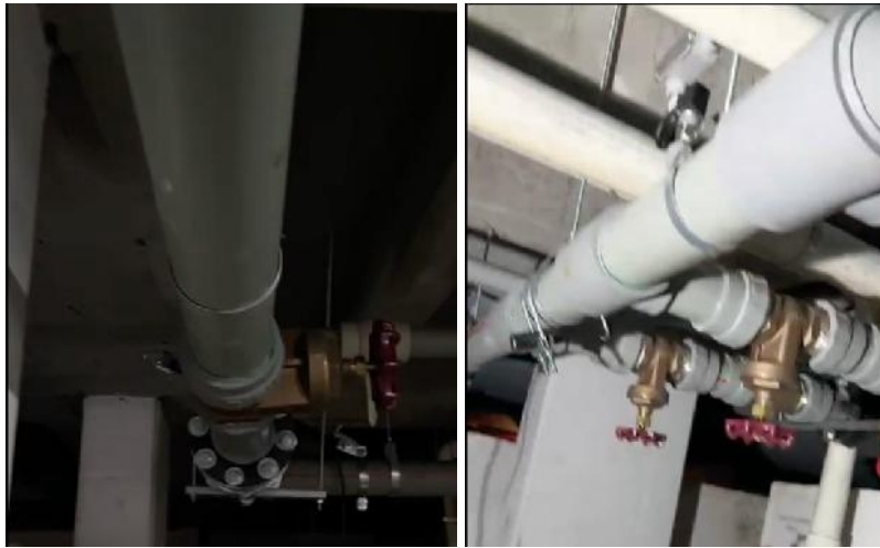
Imagen 7,8. Avance Instalación equipo de bombeo para conexión de bombas y salida de descarga general.
