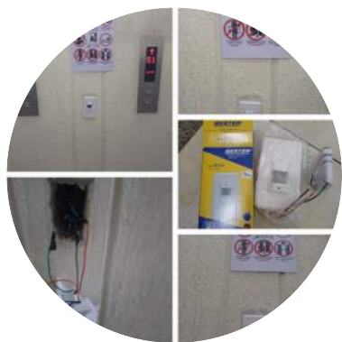
sensor torre 2 piso 9
