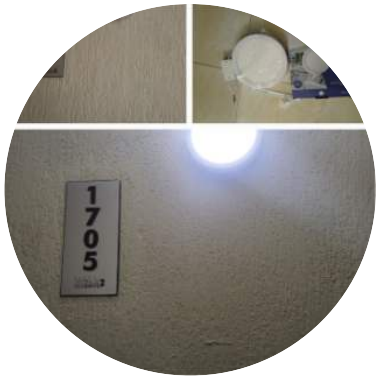
Cambio de farola en la torre 4 piso 17
