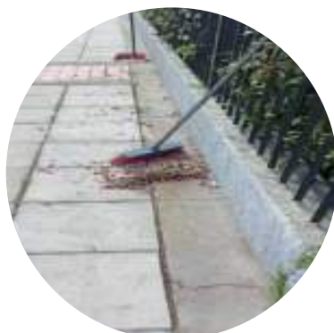
Barido perimetral parte externa del conjunto
