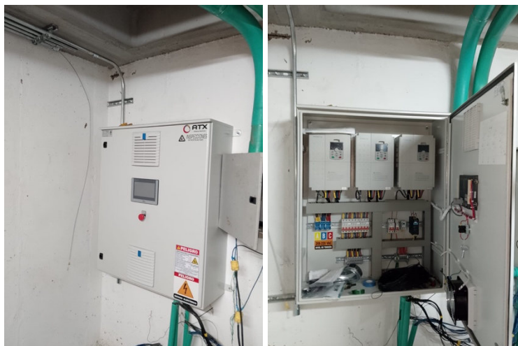
Imagen 7,8. Posicionamiento y conexonado de tablero de control.
