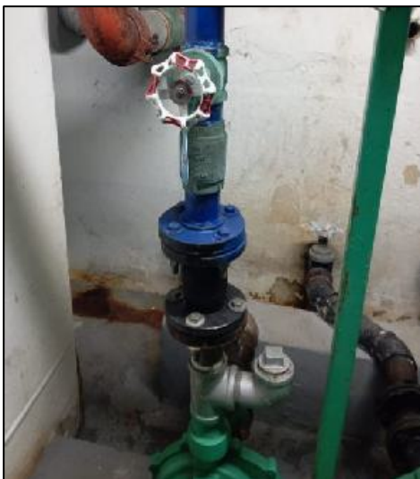
Parte de tubería de succión
