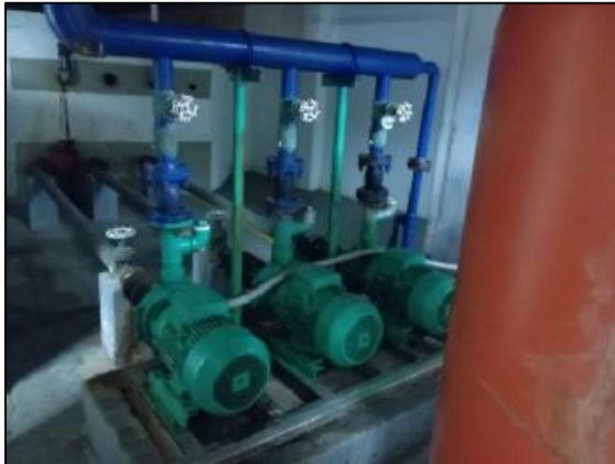
Tubería de descarga
