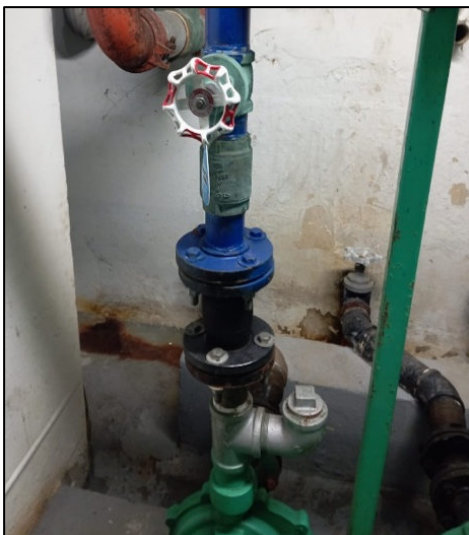
Parte de tubería de succión
