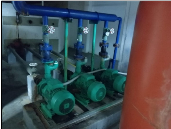
Tubería de descarga
