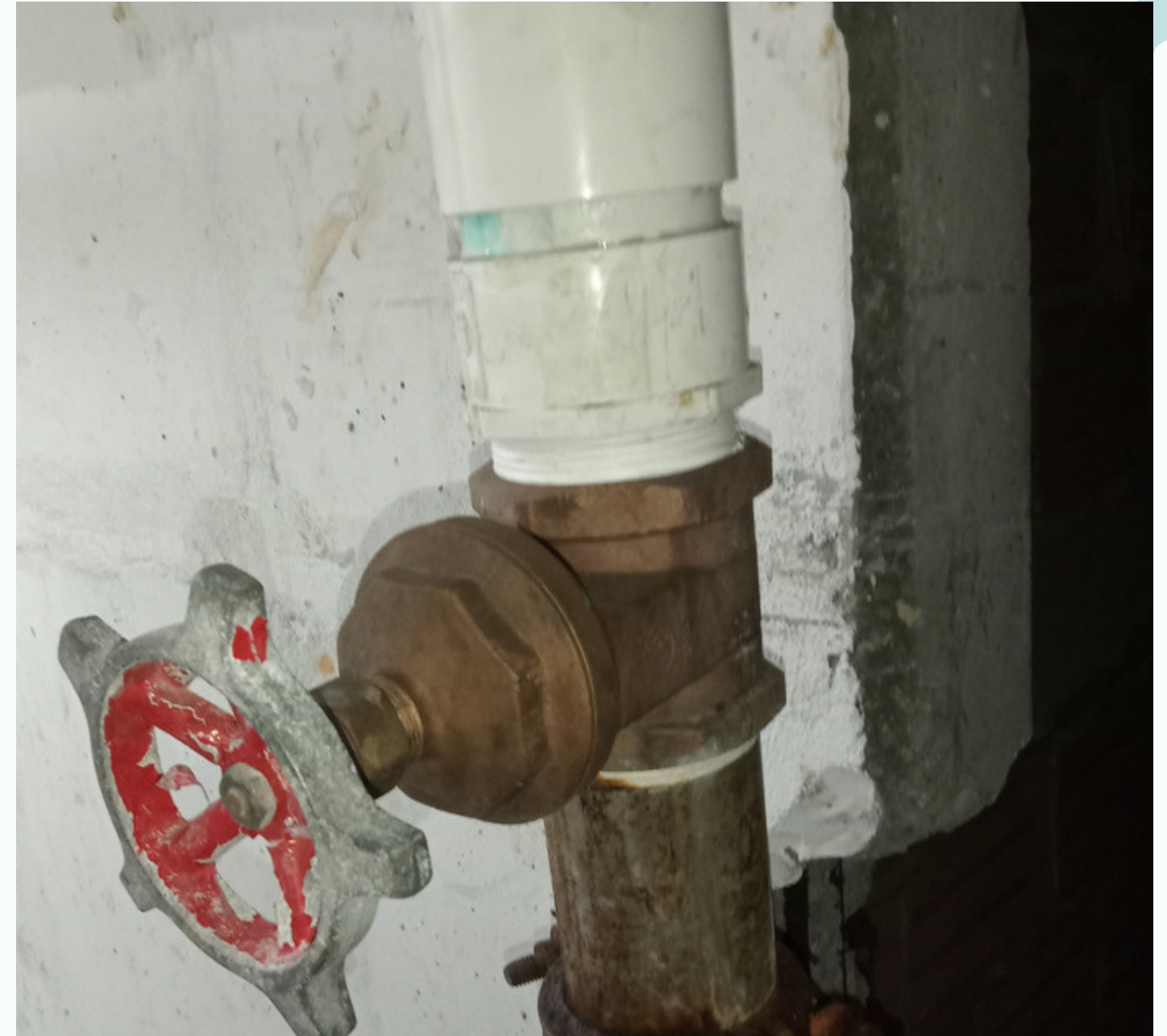
VALVULA FLOTADOR TORRE 3
